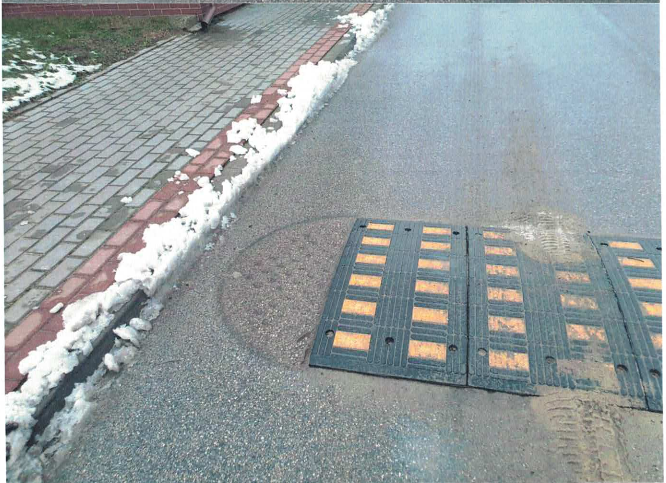
Zdjęcia od nr 1 nr i nr 2 - Widok brakującego elementu progu zwalniającego na ulicy Słonecznej w Wysokiej.
