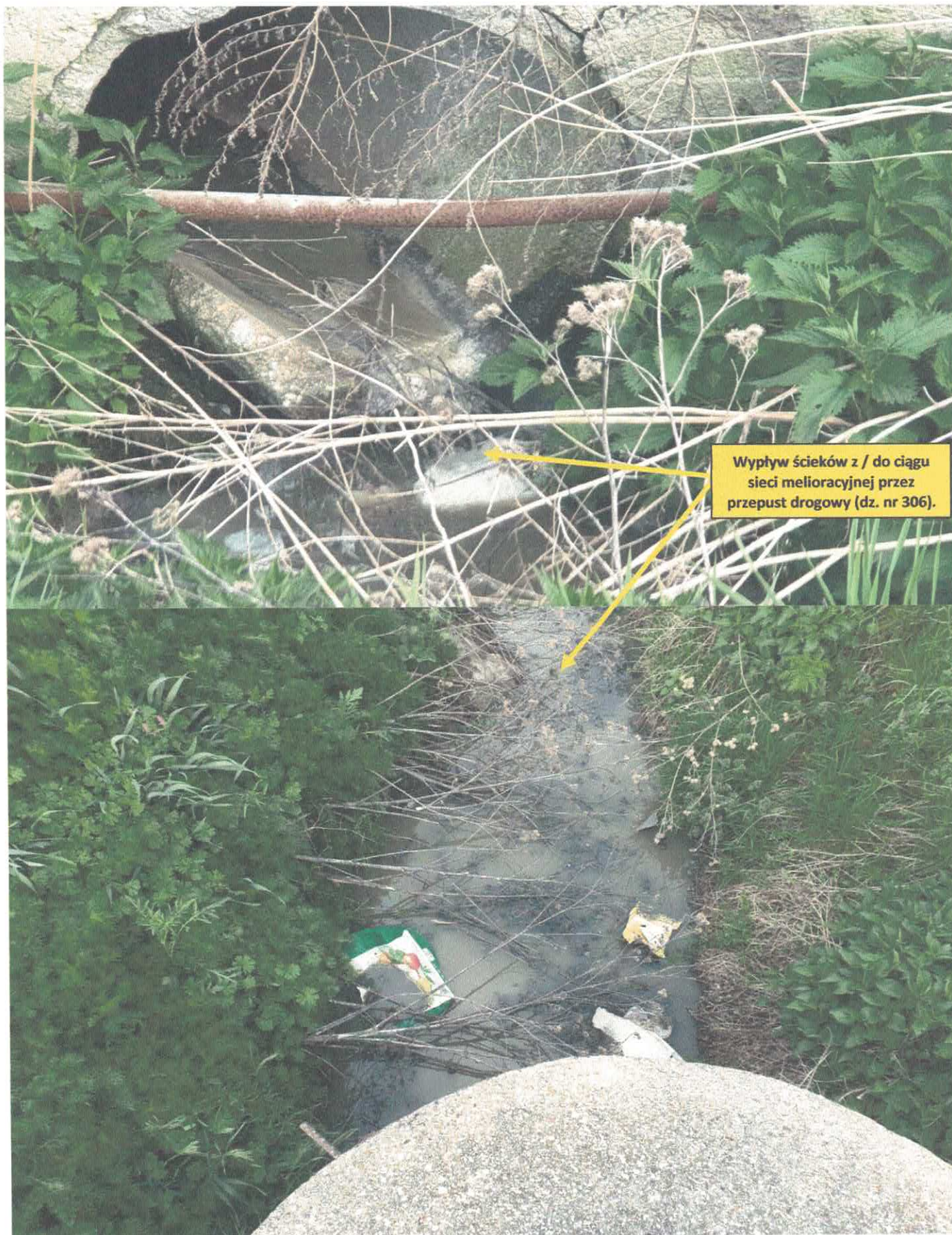
Zdjęcie nr 1 i nr 2 - Widok wypływających ścieków z infrastruktury / sieci melioracyjnej i przepustu drogowego. Opracował: Henryk Stańczyk ; dnia 15.05.2020r.
