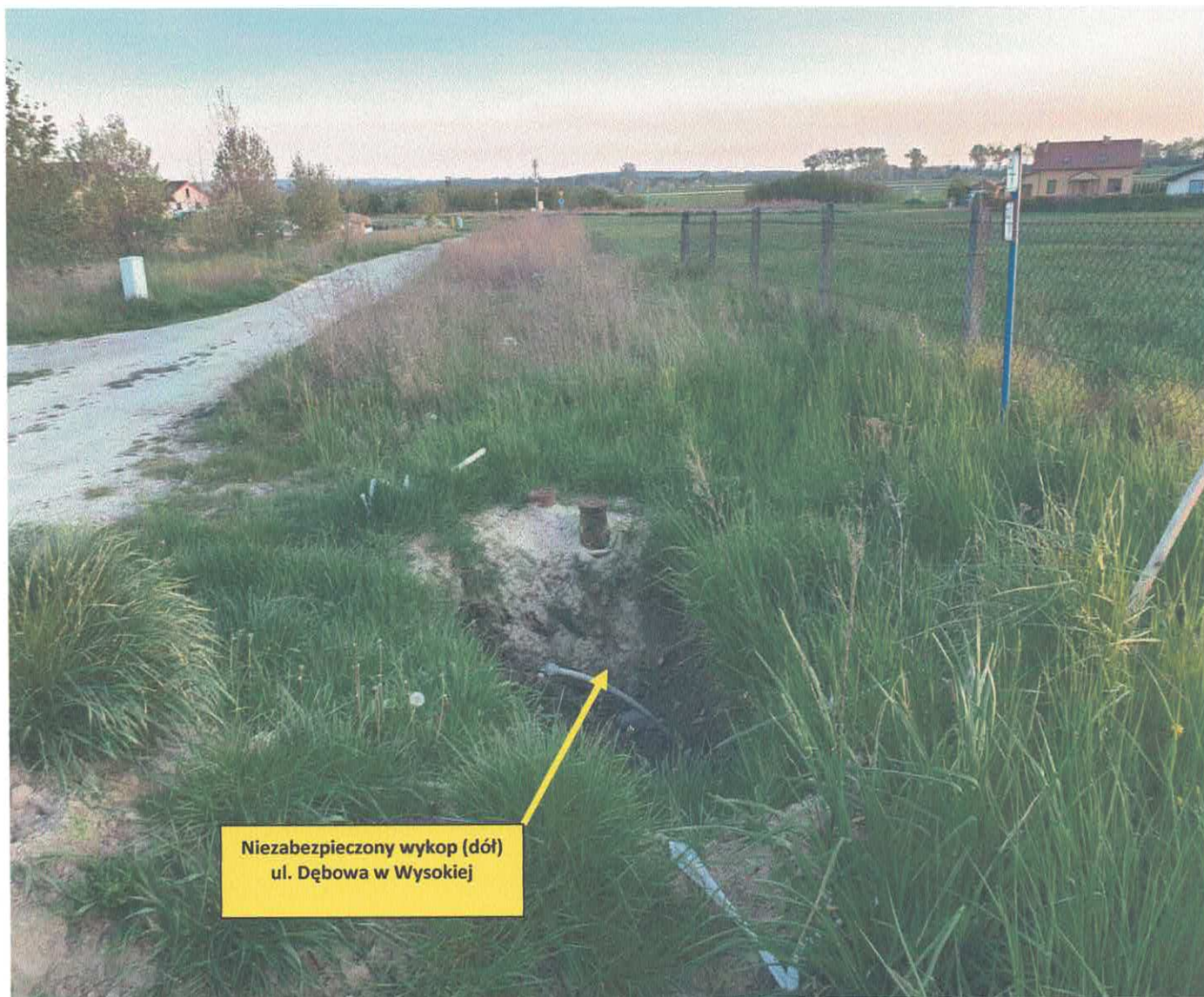
Zdjęcie nr 1 - Widok niezabezpieczonego wykopu ziemnego (dół) na ul. Dębowej po robotach budowy sieci wodociągowej.
